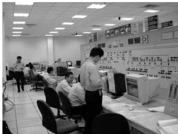
図2. Fong-Der中央制御室 — 中央制御室からすべての機器の操作・監視を可能としている。
