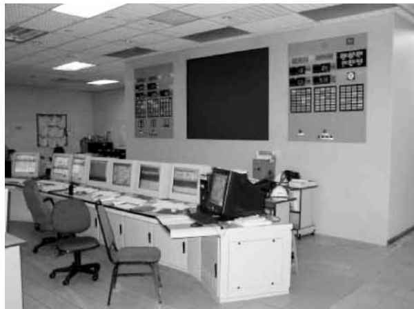
図7. リハビリ後のブロック制御室 — 大型スクリーン及びHMIによる集中監視・制御を実現している。 Human-machine interface in block control room after rehabilitation
