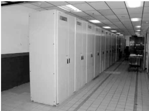
図5. PAKA フェーズ1 DCS 筐体 — TOSMAP-DS™によるDCS更新後を示す。 DCS panels after rehabilitation
