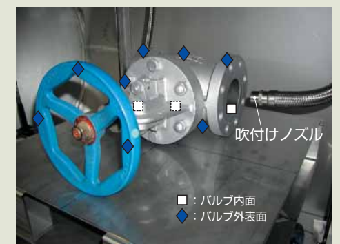
(a) 吹付けによる検査例
