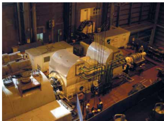
水素冷却タービン発電機 (445 MVA-15 kV-力率0.9-効率99%) Hydrogen-cooled turbine generator (445 MVA-15 kV-0.9 p.f.-99%)
