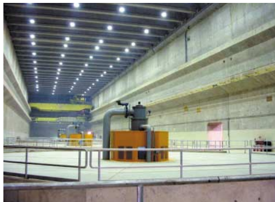
322.2 MVA水車発電機 322.2 MVA hydroelectric generator
