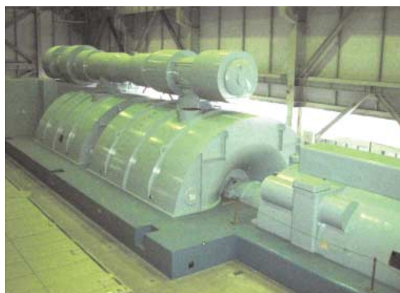
苓北発電所2号機700 MWタービン・発電機 700 MW turbine generator at Reihoku Thermal Power Station of Kyushu Electric Power Co., Inc.
