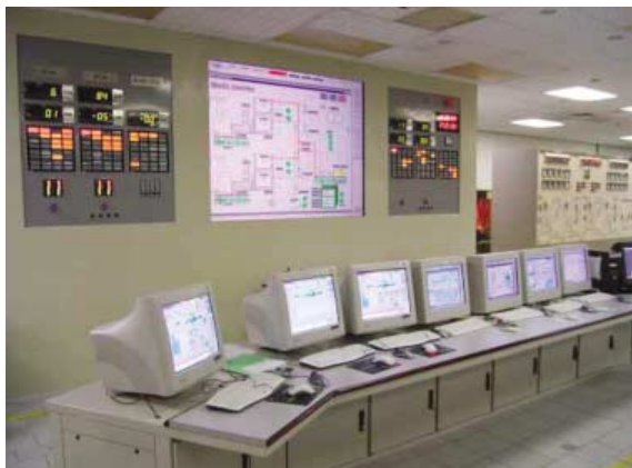
TNBG Sultan Ismail Paka発電所 2号機の新中央操作室 New block control room at No. 2 Unit of TNBG Sultan Ismail Paka Power Station
