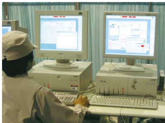
東京電力（株）大井火力発電所 2号機監視操作装置 Operator station at Ooi No. 2 Unit of The Tokyo Electric Power Co., Inc.
