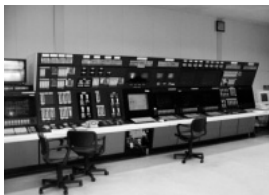
図5．中央操作室 - 監視計器類、警報窓、CRTなどが設置され、また十分なスペースも確保されて各ユニットの監視制御が行われている。
