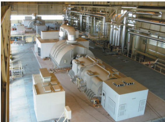
蒸気タービン・発電機の外観(スエズガルフ発電所) Steam turbine and generator at Suez Gulf Power Station
