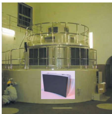
新素材軸受(中央)を採用した水車・発電機 Hydroelectric plant applying Polytetrafluoroethylene (PTFE) bearing
