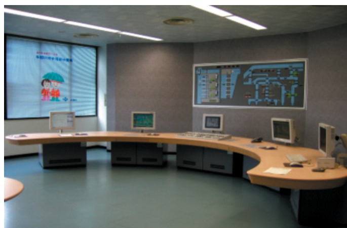
大阪府平野川分水路排水機場の監視制御室全景 Control center in drainage pump station
