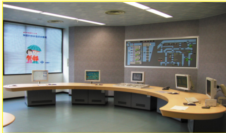
図1 大阪府平野川分水路排水機場の監視室 河川水位予測システムが導入されており、左端の監視用ディスプレイに、河川水位予測値が10分間隔で1時間分表示されます。
