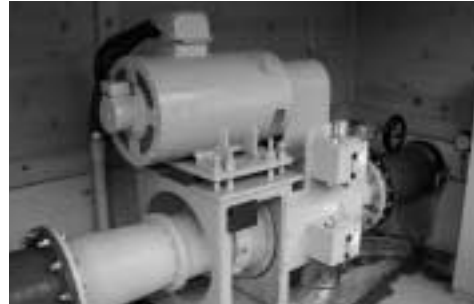
図4 . 小水力発電の外観 水車上部に発電機を搭載した一体構造で、2 ~ 15m の低落差に対応できる。 Small-scale hydroelectric power system installed on water wheel
