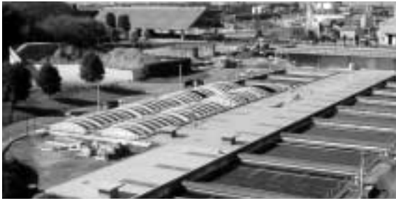
図3 . 太陽光発電の外観 ろ過池の上部に設置した太陽光発電の外観を示す。 Photovoltaic power generation system installed in upper part of filtration pond
