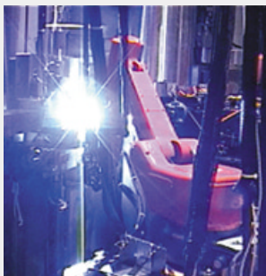
ジェットポンプ据付けロボットを用いた溶接作業状況 Welding work using jet pump installation robot
