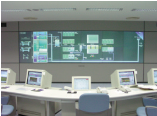
東京都下水道局新河岸東処理場納入 電気計装・監視制御システム Electric instrumentation and supervisory control system for Shingashi-east Wastewater Treatment Plant
