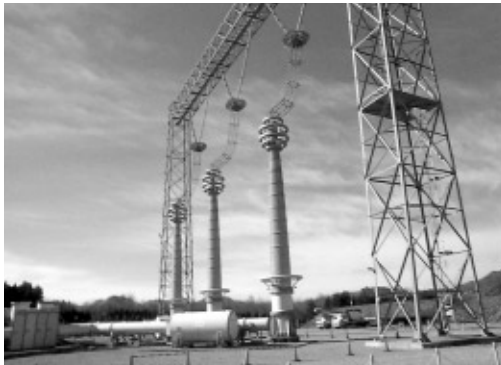
図1. 東京電力(株)UHV機器試験場 将来の1,000kV系統のGIS、変圧器と保護制御システムの構成、及び課題の検証を行っている。 UHV equipment pilot plant of TEPCO
