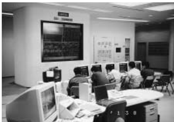
図5.最新鋭コンバインドサイクル発電プラントの中央操作室 CRTタッチオペレーションに加え、マウス操作を採用し使いやすさを増している。
