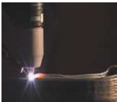
図3．ロボットによる動翼溶接補修 ガスタービン動翼先端部の溶接補修状況を示す。
