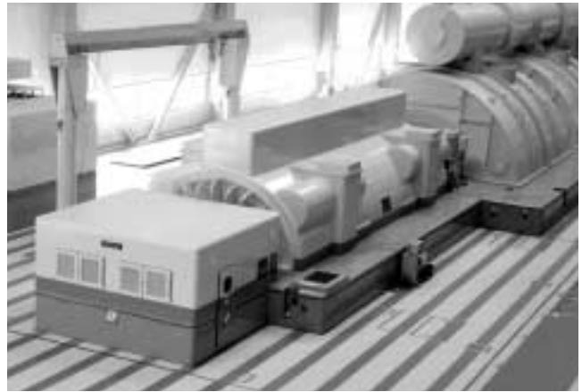
図4 . 据付けられたタービン発電機 中部電力(株)碧南4号機は, 2001年11月運転開始の予定である。 1,000 MW turbine generator at Hekinan Thermal Power Station
