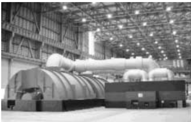
図3. 電源開発(株)橘湾火力発電所1号機 大型商用機として世界最高の蒸気条件(25 MPa, 600/610 °C)を採用している(2000年7月営業運転開始)。 Tachibana Bay Power Station No. 1 Unit of Electric Power Development Co., Ltd.
