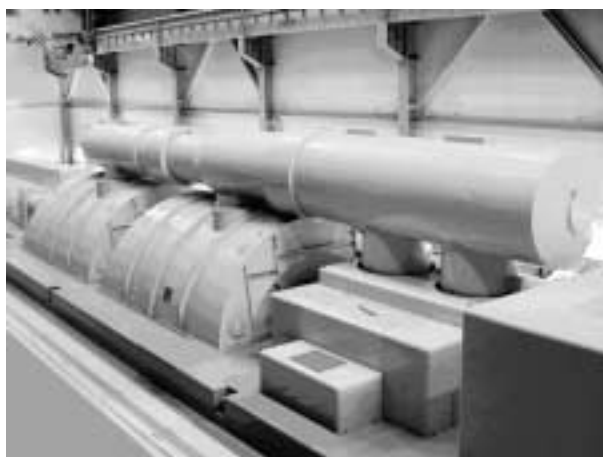
図 7 . 中部電力 (株) 碧南火力発電所 4 号機、1,000 MW タンデム機外観 世界最大級で、2001 年 11 月運開予定である。 1,000 MW tandem machine at Hekinan Thermal Power Station No. 4 Unit of Chubu Electric Power Co., Inc.
