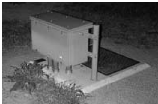
図3. 信号伝送装置の外観 信号伝送装置は、飛行場内フィールドに設置されている。 Local station
