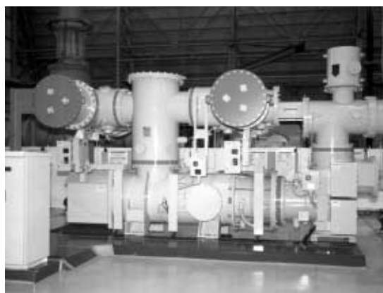
図 1 . 240/300 kV GIS の総組立検証姿 基本ユニット 1 回線の総組立状態で検証を実施し、良好な結果を得ている。
