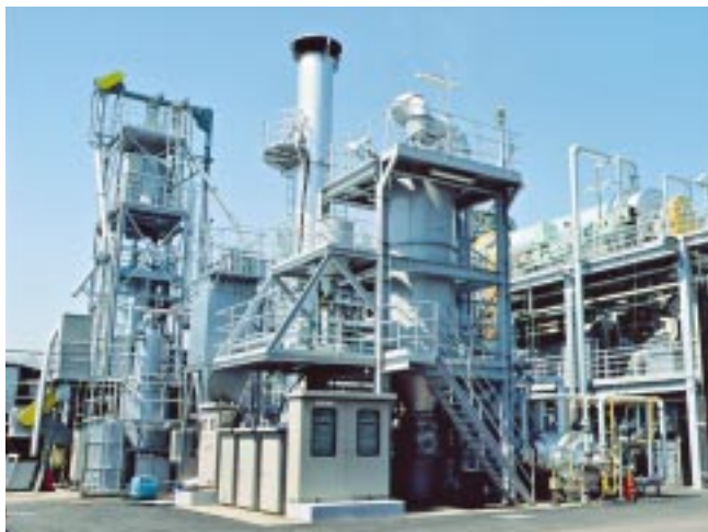
日量10 t 熱分解ガス化改質・溶融実証試験設備 10 t/day pyrolysis gasification test facility
