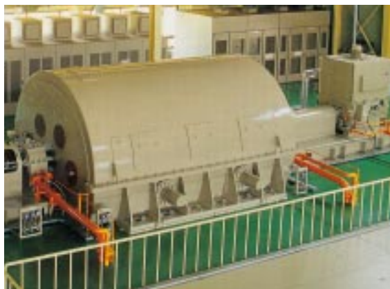
短絡発電機 Short-circuit generator
