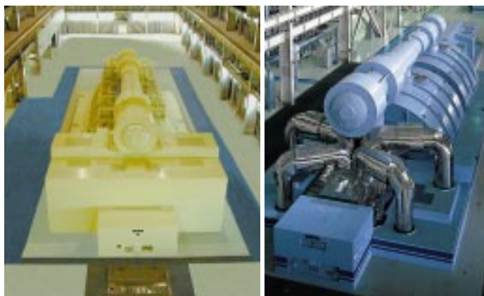
蒸気タービン外観(左:橘湾発電所 右:敦賀火力発電所第2号機)
