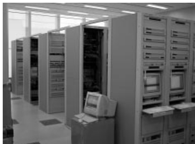
図1 . BSデジタル放送送出設備のラック群 日本衛星放送(株)(WOWOW)に納入したラック群。省スペース、低消費電力を実現している。
