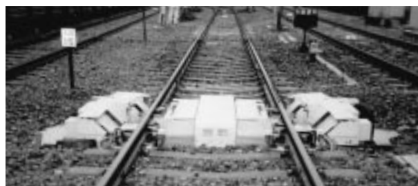
図5. 車輪形状・制輪子摩耗検査システムのセンサ部実施例 車輪形状検査システムと制輪子摩耗検査システムのカメラ・照明を一体化した計測装置を線路下に設置している。
