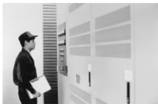
図6 . 275 kW需要家向け実証用非常電源機能付きNAS電池電力貯蔵用PCS 需要家設置用として自立運転機能を持つ。 (写真提供：東京電力(株))
