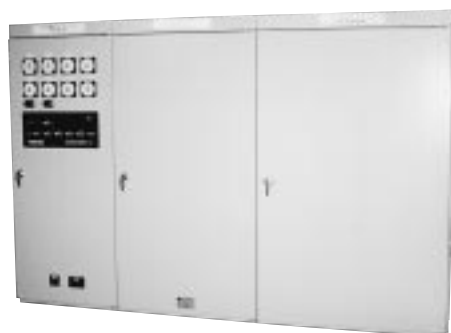
図7 . 200 kW周波数調整機能付きNAS電池電力貯蔵用PCS BESS機能の実証用として、太陽光発電の出力変動抑制、ガバナフリー、無効電力調整などの機能を持つ。
