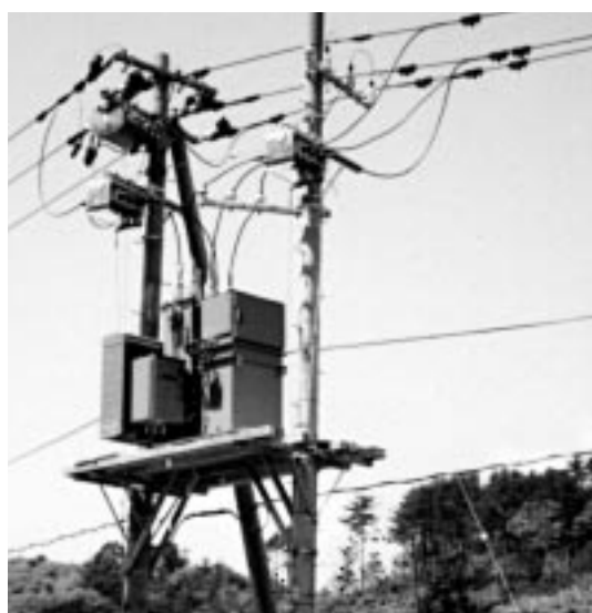
図1 装柱状態のTVR TVRは2本の電柱を使用して設置する。手前がサイリスタタンクである。 View of TVR installation
