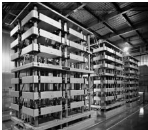
図14．紀伊水道直流連系設備向けサイリスタバルブ このバルブで250kVの12パルスブリッジを構成する。 Thyristor valve for Kii Channel HVDC transmission system
