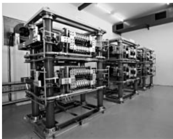
図15．オーストラリアLismore向けSVCサイリスタバルブ 正面に逆並列接続の光サイリスタが配置されている。 SVC thyristor valve for Lismore Substation
