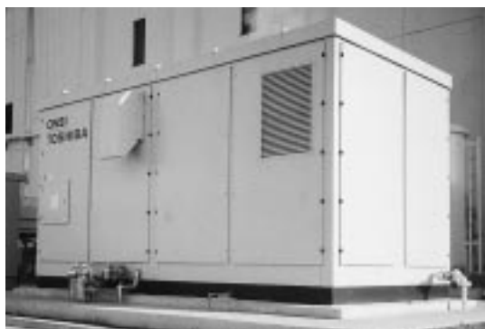
図6 . 燃料電池の外観(横浜市北部汚泥処理センター) この燃料電池は, 99年11月から稼働している。
