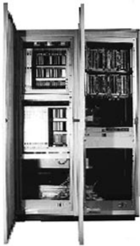
図5 . 通信制御装置 増減可能なユニットがラックに格納されている。 CCU exchange equipment
