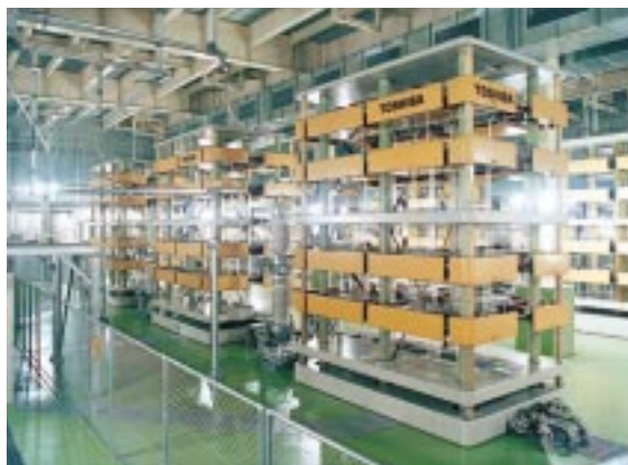
南福光連系所 300 MW交直変換装置(サイリスタバルブ) 300 MW thyristor valve at Minami-Fukumitsu Converter Station of Chubu Electric Power Co., Inc.
