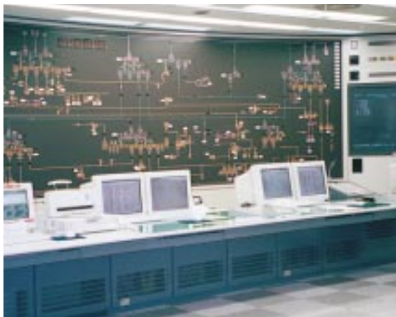
山形給電指令所 指令室 Control room at Yamagata Regional Dispatch Center
