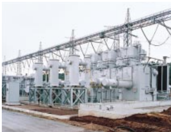
東京電力(株)新京葉変電所向け 500 kV・300/3 MVA分路リアクトル 500 kV-300/3 MVA reactor for Shin-Keiyo Substation of The Tokyo Electric Power Co., Inc.
