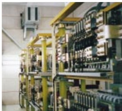
リズモア変電所SVCサイリスタバルブ Thyristor valve for Lismore Substation static var compensator
