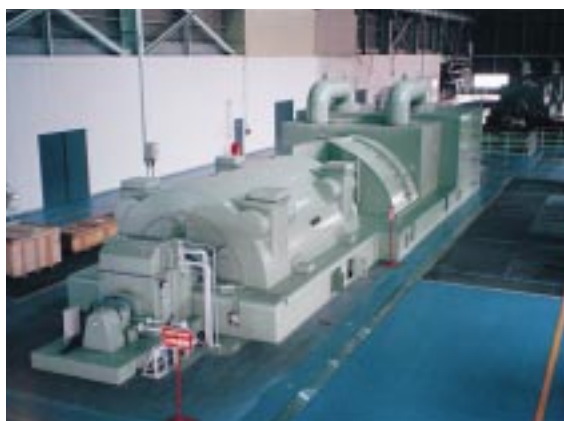
東ソー( 株 ) 南陽事業所タービン・発電機全景 Turbine and generator for TOSOH Co., Ltd. Nanyo Complex
