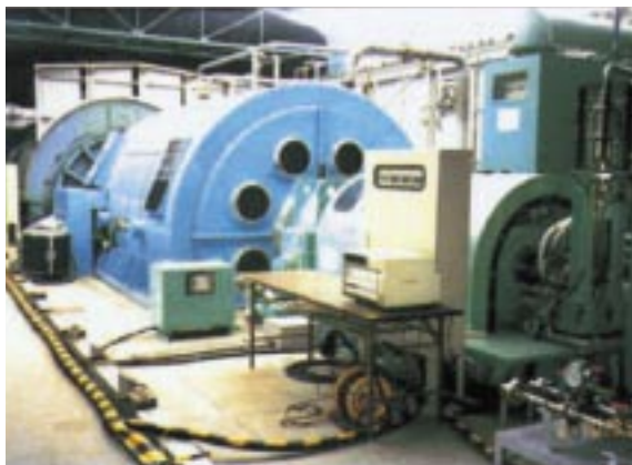
70 MW級超速応型超電導発電機 70 MW superconducting generator
