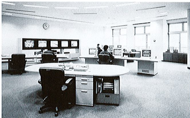
図1. 相模取水管理事務所中央管理室 最新鋭TOSWACS™-Gx3台とITVモニタ5台が中央に設置されている。
