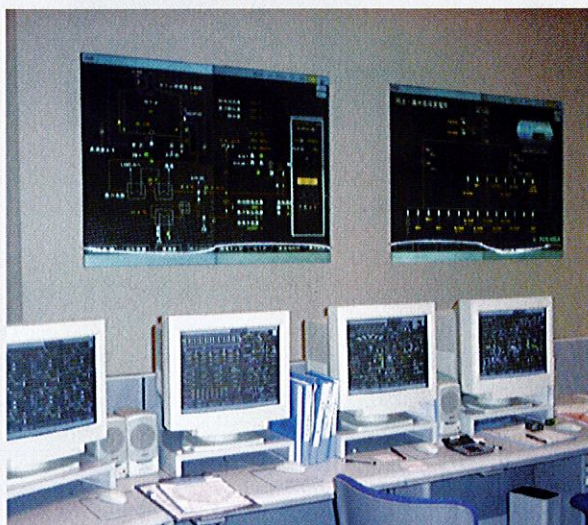
中央監視装置 Central monitoring system
