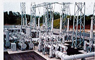
中国電力(株) 西島根変電所納入 550kV GIS 550 kV GIS for Nishi-Shimane Substation of The Chugoku Electric Power Co., Inc.
