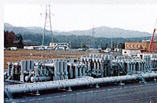
東京電力(株) 南いわき開閉所納入 550kV GIS 550 kV GIS for Minami-Iwaki Switching Station of The Tokyo Electric Power Co., Inc.
