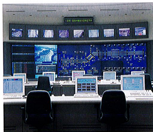
本州四国連絡橋公団 神戸淡路鳴門自動車道 交通管制・施設制御システム Supervisory and control system for Kobe-Awaji-Naruto Expressway of Honshu-Shikoku Bridge Authority
