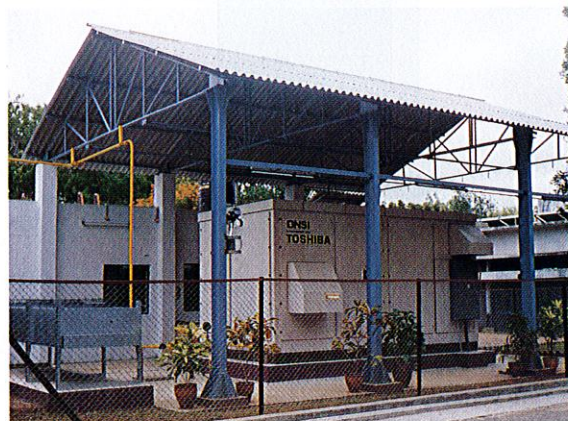
インドで運転中の200kW燃料電池(PC25 TM C) 200 kW fuel cell power plant installed in India(PC25 TM C)
