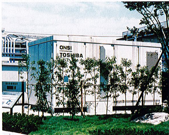
ビール会社に導入した200kW燃料電池(PC25 TM C) PC25 TM C 200 kW phosphoric acid fuel cell
