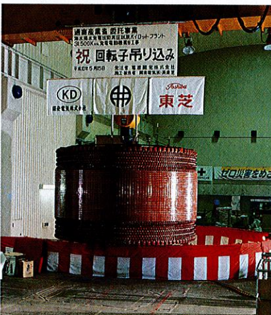
可変速発電電動機回転子のつり込み状況 Adjustable-speed generator-motor rotor assembly
