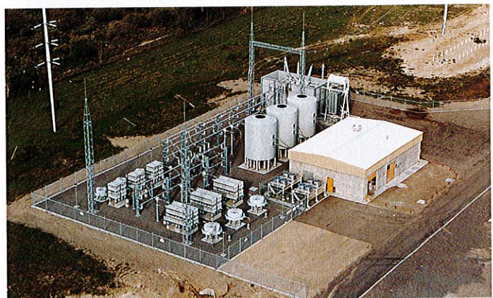
ロス変電所 SVC 全景 Overview of Ross Substation static var compensator
