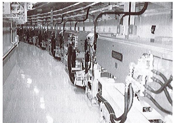
図1. シンクロトロントンネルに据え付けられた偏向電磁石 偏向電磁石は製作後，検査，磁場測定試験を経て精密にアライメントされた。
