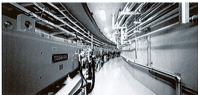
図6. シンクロトロン電磁石 シンクロトロン電磁石は、偏向電磁石64台、四極電磁石80台、六極電磁石60台から構成され、これらが、0.1 mm オーダの精度で全周にわたって据え付けられている。 Synchrotron magnets
