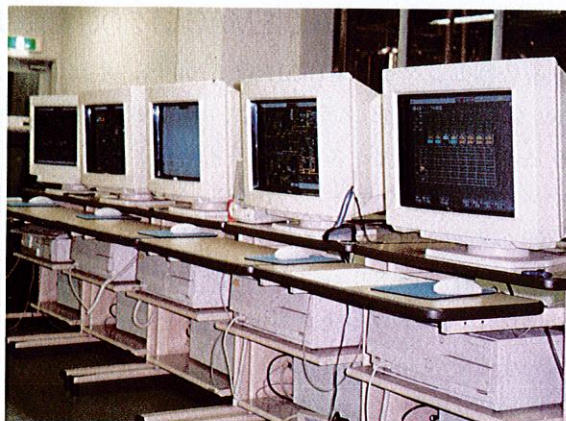
中央監視装置 Central monitoring system
