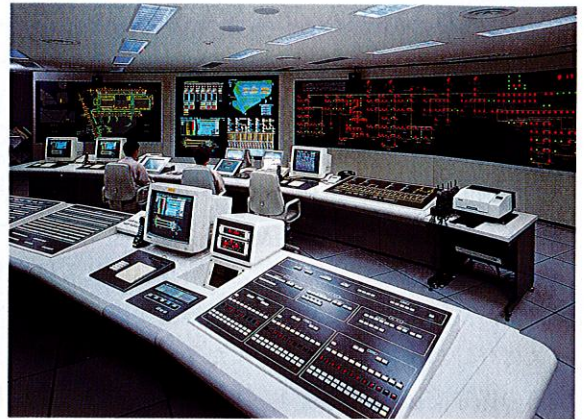
中央監視室 Main control room
