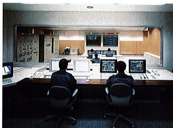
シミュレータ訓練室 Training room for thermal power plant operators
