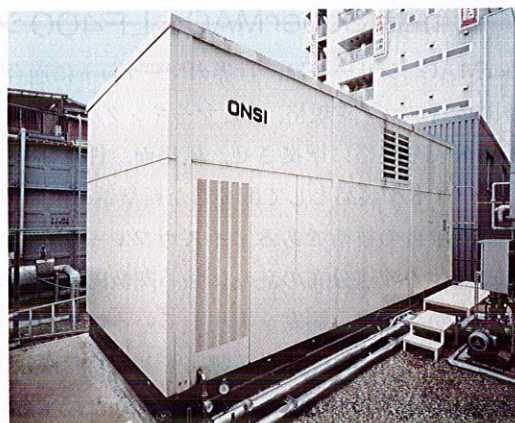
梅田センタービルに設置の 200 kW 燃料電池 PC25 TM A PC25 TM A 200 kW fuel cell power plant in Umeda Center Building
