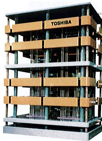
東清水周波数変換所向け300 MW光サイリスタバルブ 300 MW thyristor valve for Higashi-Shimizu Frequency Converter Station
