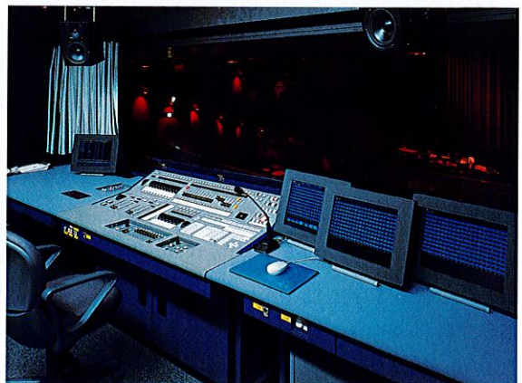
新国立劇場 調光卓 Lighting console of New National Theater, Tokyo
