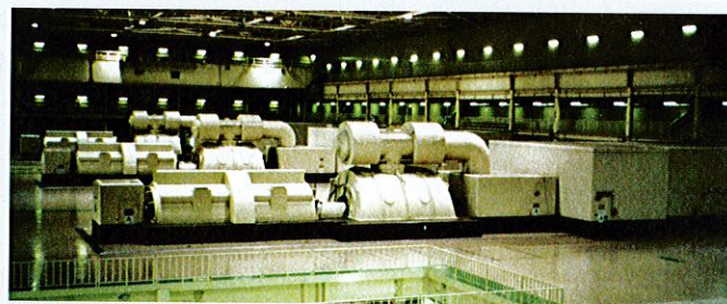
東京電力（株）横浜火力発電所7号系列コンバインドサイクル発電設備
