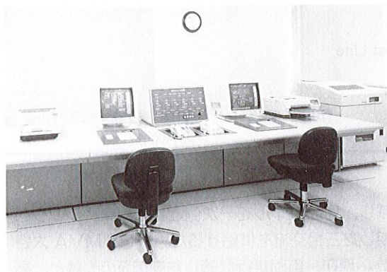
図3. 保守区システムの設備監視卓 設備保全を目的にリアルタイムな監視制御とデータの解析診断・支援などを行う。
