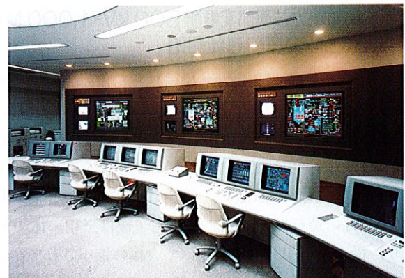
新たに設置された中央操作室 Newly built control room
