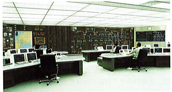
中部電力株中央給電指令所制御室 Control room of Central Load Dispatching Center of Chubu Electric Power Co., Inc.
