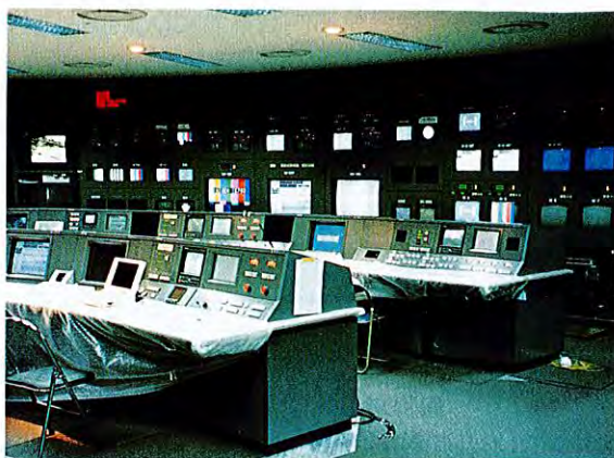
㈱フジテレビジョンに納入した送出系設備 Master control system of Fuji Television
