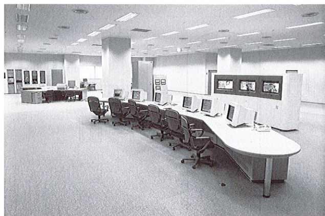
図9. 中央監視室 総合デザインを実施した監視室。快適な操作環境を提供している。
