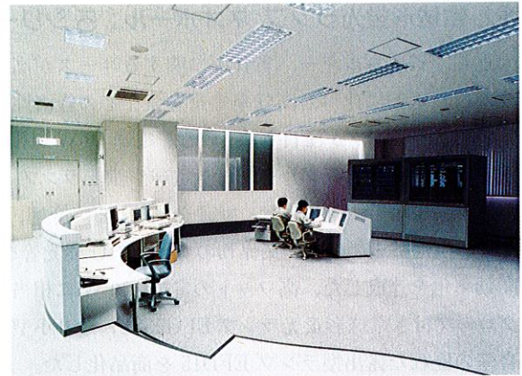
施設制御室 Control room
