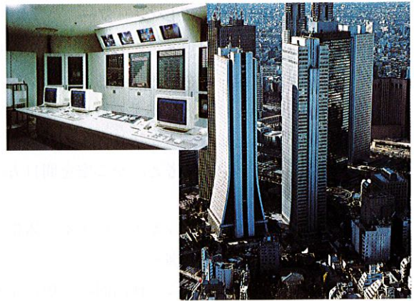
新宿野村ビル(中央)と中央監視室 Shinjuku Nomura Building and control room
