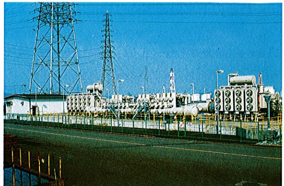
山陽特殊製鋼(株) 275 kV 受変電設備 275 kV substation
