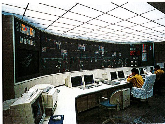
中央給電指令所指令室 Operation room of central dispatch center
