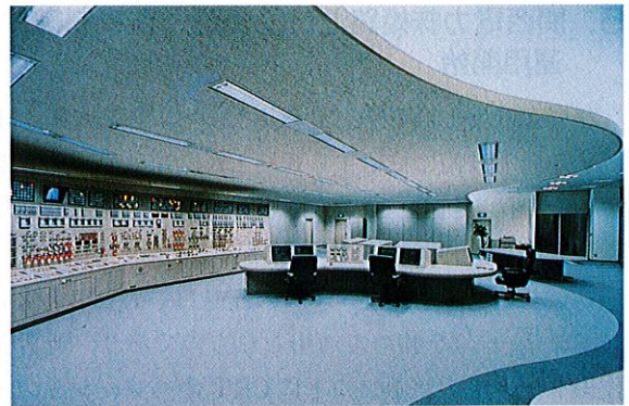
中央制御室 Central control room
