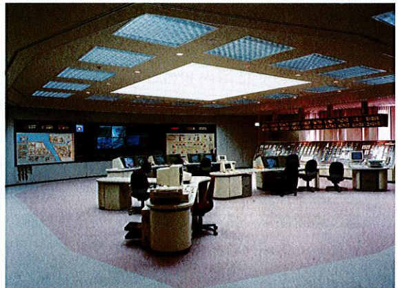
最新マンマシンシステムを備えた中央制御室 Control room with advanced man-machine interface system
