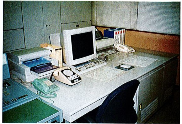
軽井沢営業所配電指令室 Control room of distribution automation system
