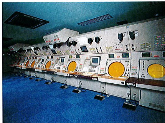
レーダ管制実習装置 Radar control training system
