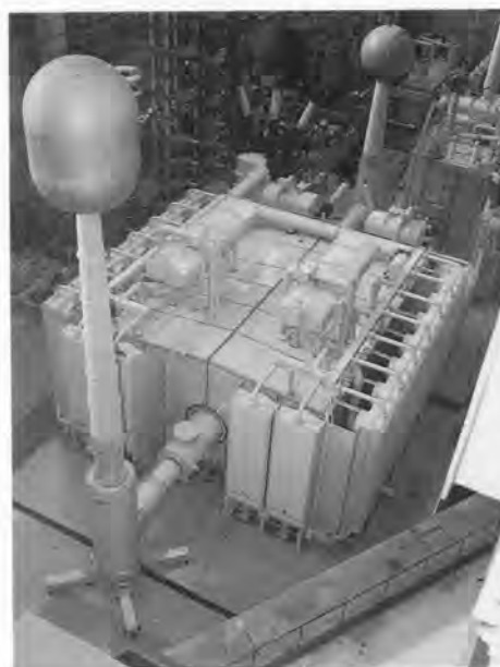
図 5. 工場完成の 1,000kV 変圧器 1,000/√3kV, 3,000/3MVA 内鉄型単相巻巻変圧器。手前が 1,000kV、奥が 500kV 端子であるが現地では GIS 直結。
