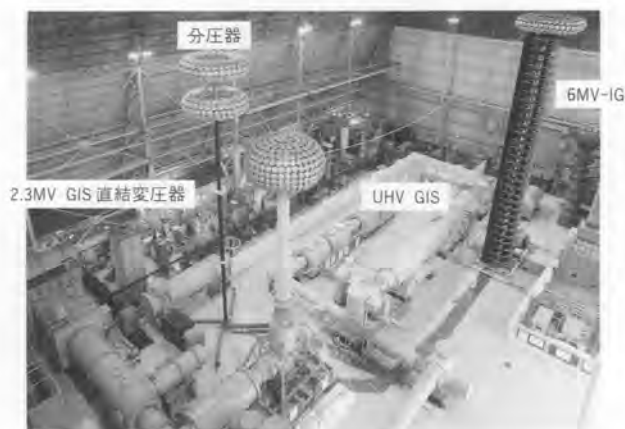
図 19. 工場内での GIS 総組立て試験 総組立て状態で高感度な部分放電試験および通電試験を実施した。
