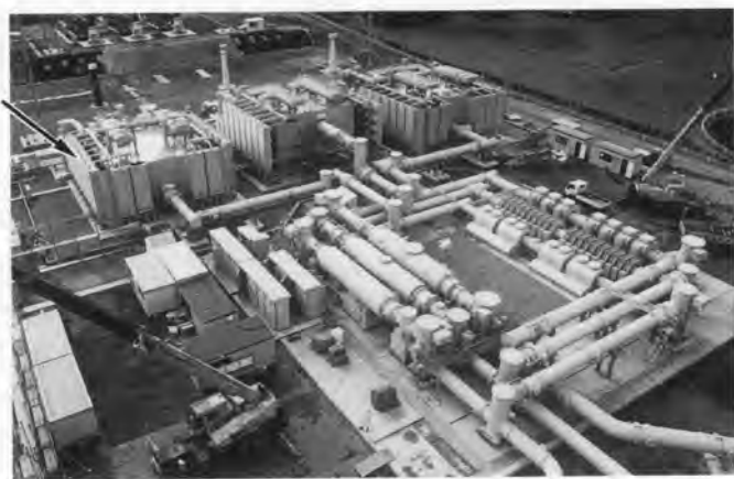
図 4. 東京電力(株)実証試験設備 (UHV 機器試験場) 矢印部が当社納入分。
