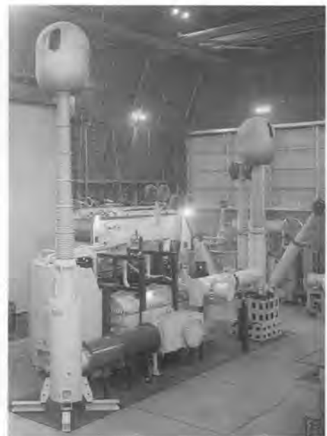
図8. 1,000kV 変圧器0号試作器試験姿 2分割構成となっている主変圧器のうち、一方の分割単位を実設計で製作し、設計・製造技術を事前検証。
