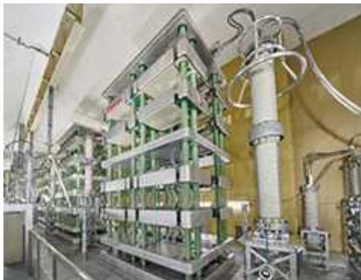
新信濃変電所に納入した交直変換器
